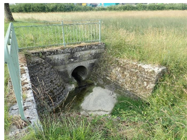
Sortie de buse formant une mare temporaire au nord-est de la ZIP
